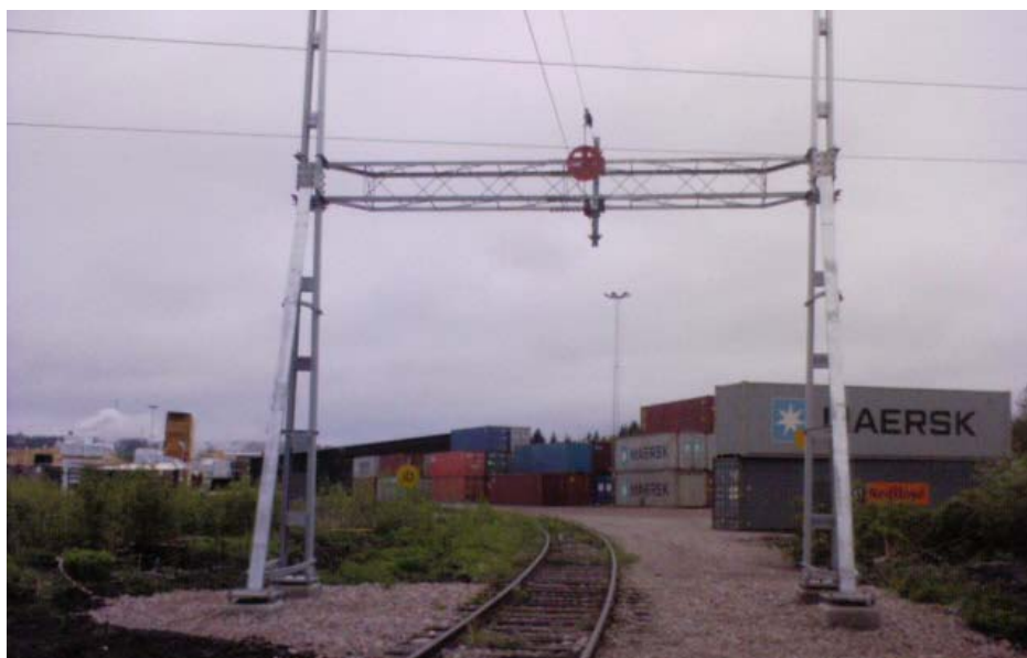
Figur 27 Industrispåret vid AB Karl Hedins Sågverk i Krylbo är elektrifierat fram till den på bilden synliga kontaktledningsbryggan. Elektrifieringen genomfördes av Banverket under 2006 och numera kan TÅGAB växla vagnar till och från industrispåret utan behov av diesellok (Foto: Fredrik Bärthel, 2007).
